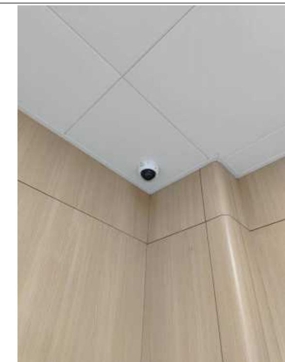
图 4-5 机房内摄像监控装置
