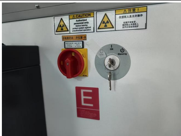
图 3-6 操作台旁钥匙开关、急停
