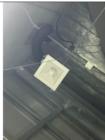
图3-14 贮存库通风设施
